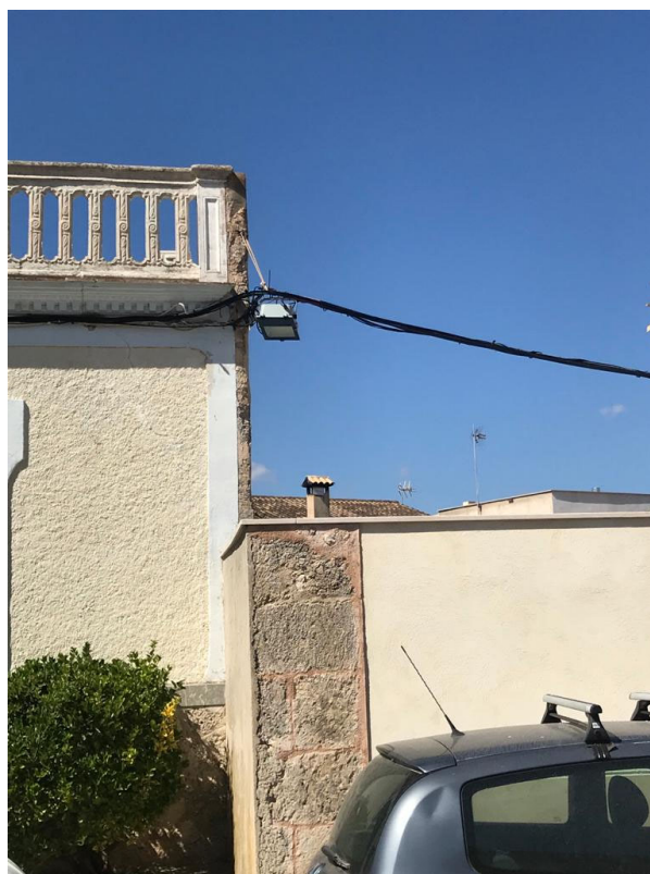
Foco a substituir n2
